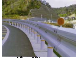
ガードレール
