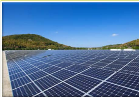
津屋崎発電所
