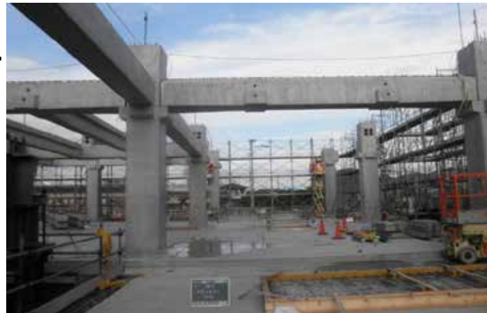
データセンター
