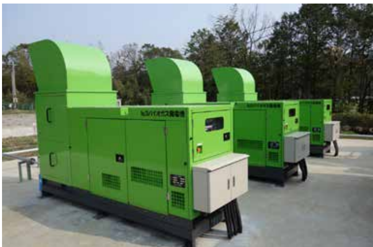
バイオ発電機
