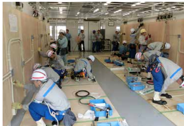
電気配線研修
