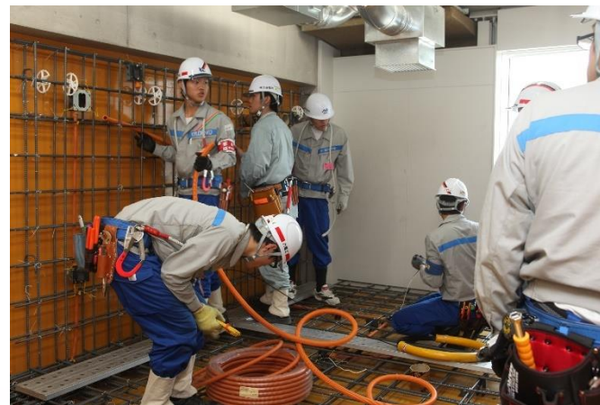
電気配線研修
