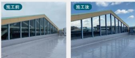
パークプレイス大分フードコートトップライト部遮熱シート施工
