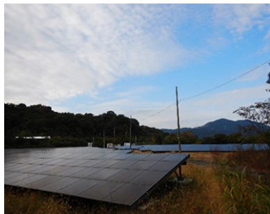
【エネ・シード飯塚太陽光発電所】
