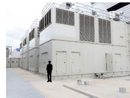
▲データセンター用非常用発電機向け防音筐体
