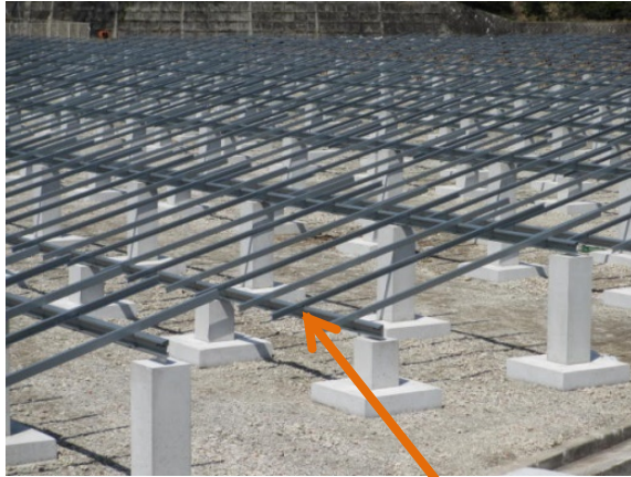
太陽電池アレイ支持架台
