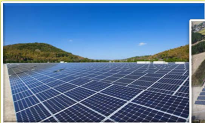
津屋崎発電所
