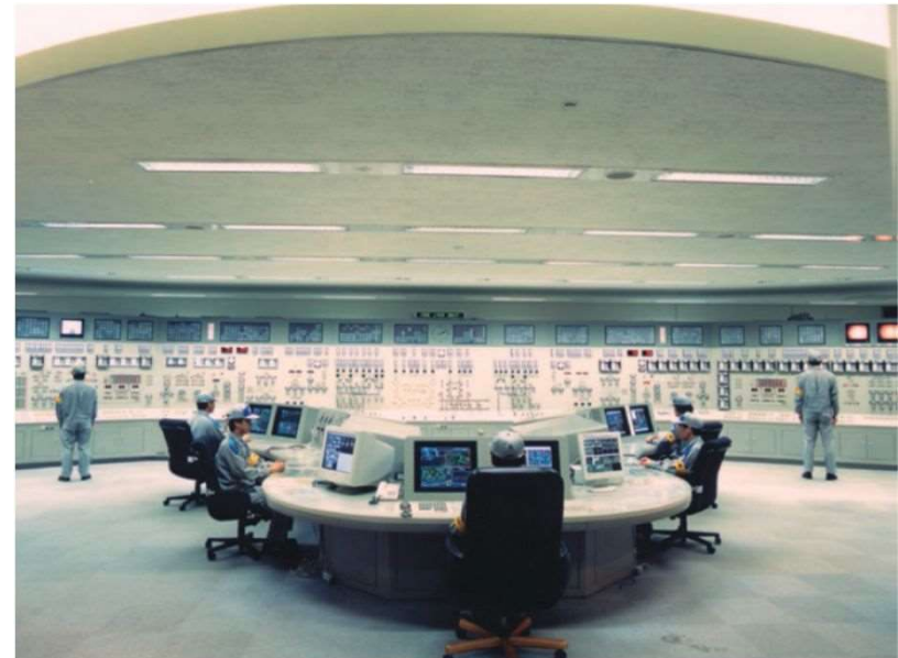
〔火力発電所での常時監視〕
